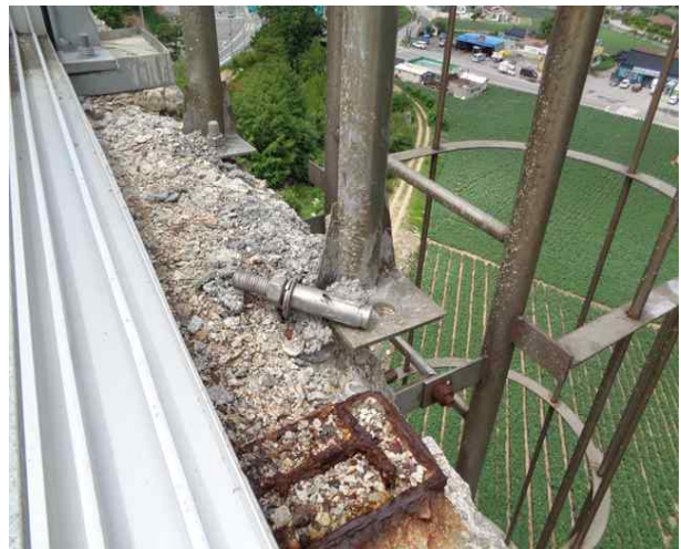
방호벽 04 S5 박락 및 점검로 앵커 지지불량
