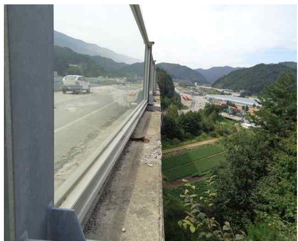
방호벽 06 S6 콘크리트 박리, 박락 및 철근노출
