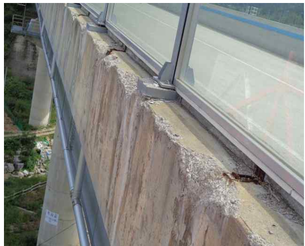
방호벽 02 S3 콘크리트 박리, 박락 및 철근노출
