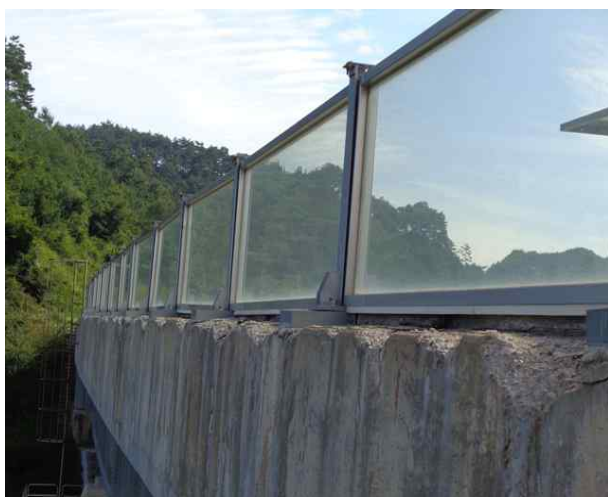
방호벽 05 S5 콘크리트 박리, 박락 및 철근노출
