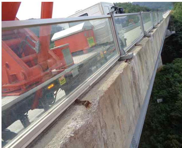
방호벽 01 S2 콘크리트 박리, 박락 및 철근노출
