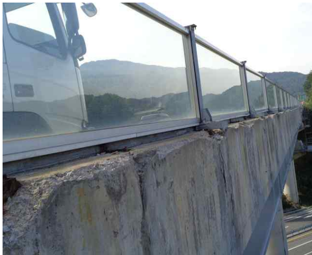
방호벽 03 S4 콘크리트 박리, 박락 및 철근노출
